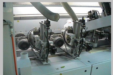
Kophoveder monteret i kantpudser.
